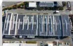
貝塚工場 2022年2月稼働 発電量：748kW
