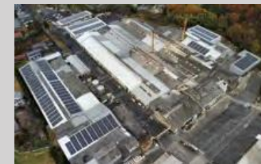
瑞浪工場 2022年11月稼働・ 2025年1月稼働 発電量：1,206kW
